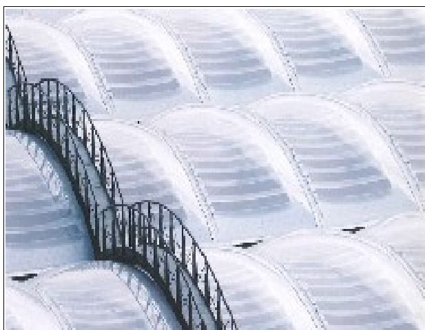
Abbildung 7: PV-Anlage des AWM auf dem Carportdach (Photo: Abfallwirtschaftsbetrieb München)
